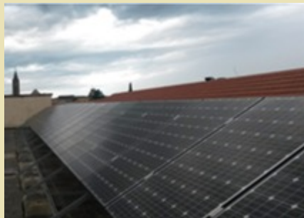
Ex Marzotto - Potenza nominale : 15 kWp, dal 2014
